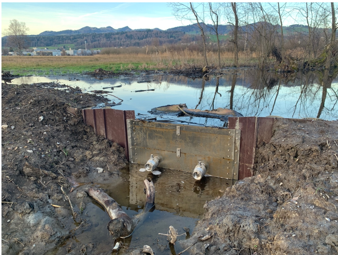
Stauwehr zur Regulierung des ehemaligen Auslaufs beim Entensee.
