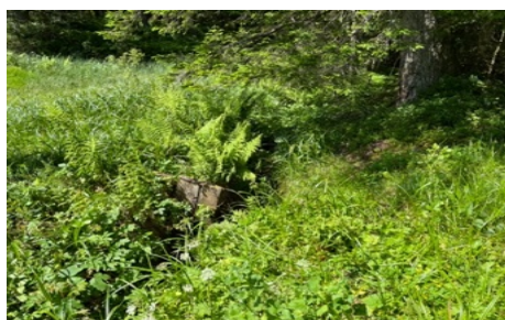
Abb. 24: Die unteren beiden Sperren sind am zerfallen und müssen ersetzt werden.
